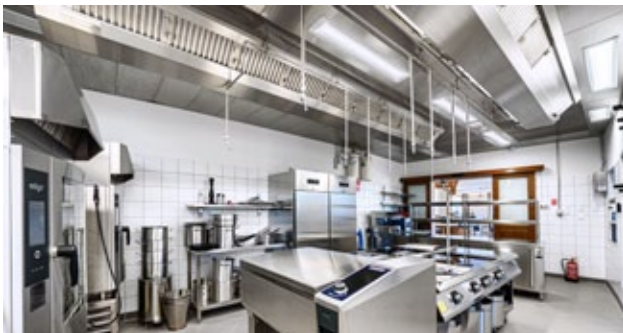
Vianen AirPlenum UV-C aktív elszívó álmennyezet előtérben túlnyomósos készülékkel (A.MeCoD Zrt. referencia)
